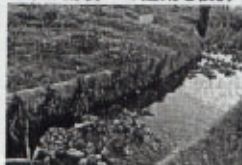
苔に覆われたコンクリート
